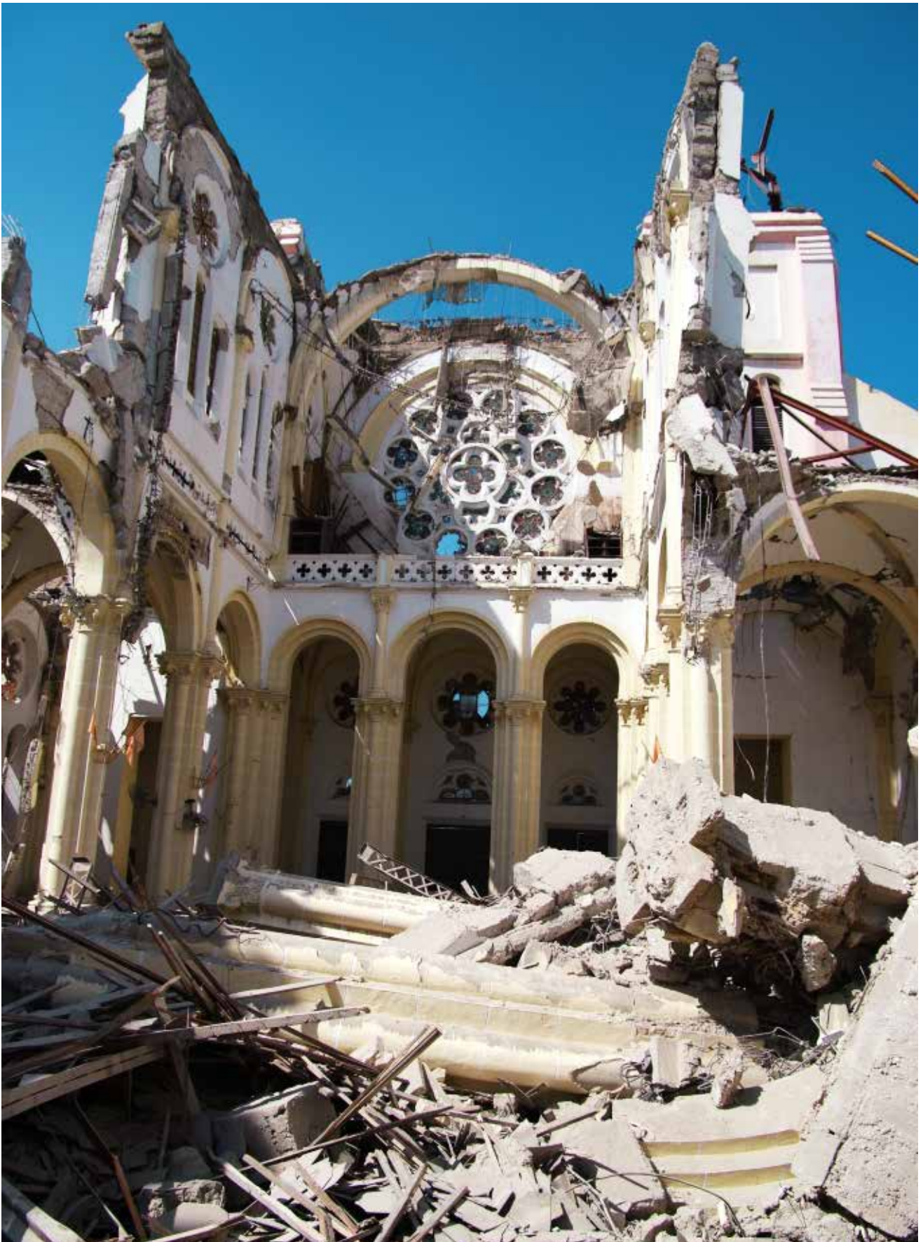
› Cathédrale de Port-au-Prince détruite par le tremblement de terre de 2010. © L. Roch, JM Girollet. Direction de la Sécurité Civile, France, 2010.
