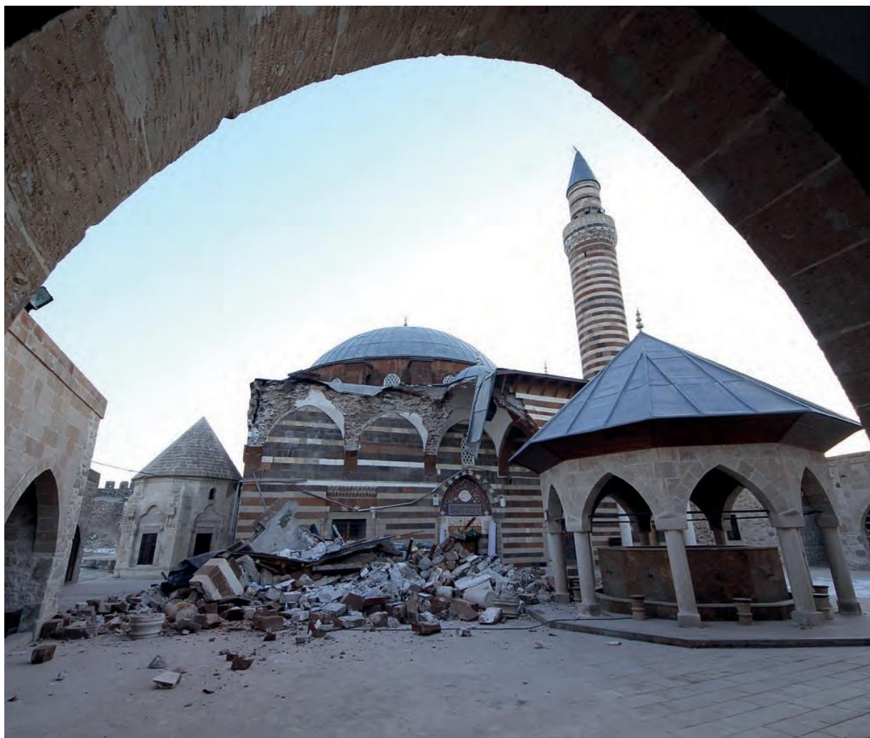
10 Les dommages causés à la mosquée Kaya Çelebi après le tremblement de terre de 2011 dans la Haute Baie de Bakraçli (Turquie)
