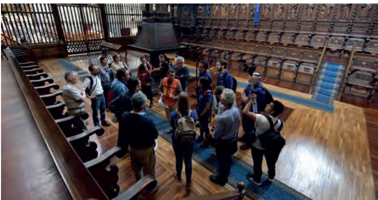
45 L'équipe EUCPT lors des inspections sur site pour évaluer les dommages sur un site culturel endommagé par les tremblements de terre de septembre 2017 au Mexique.
