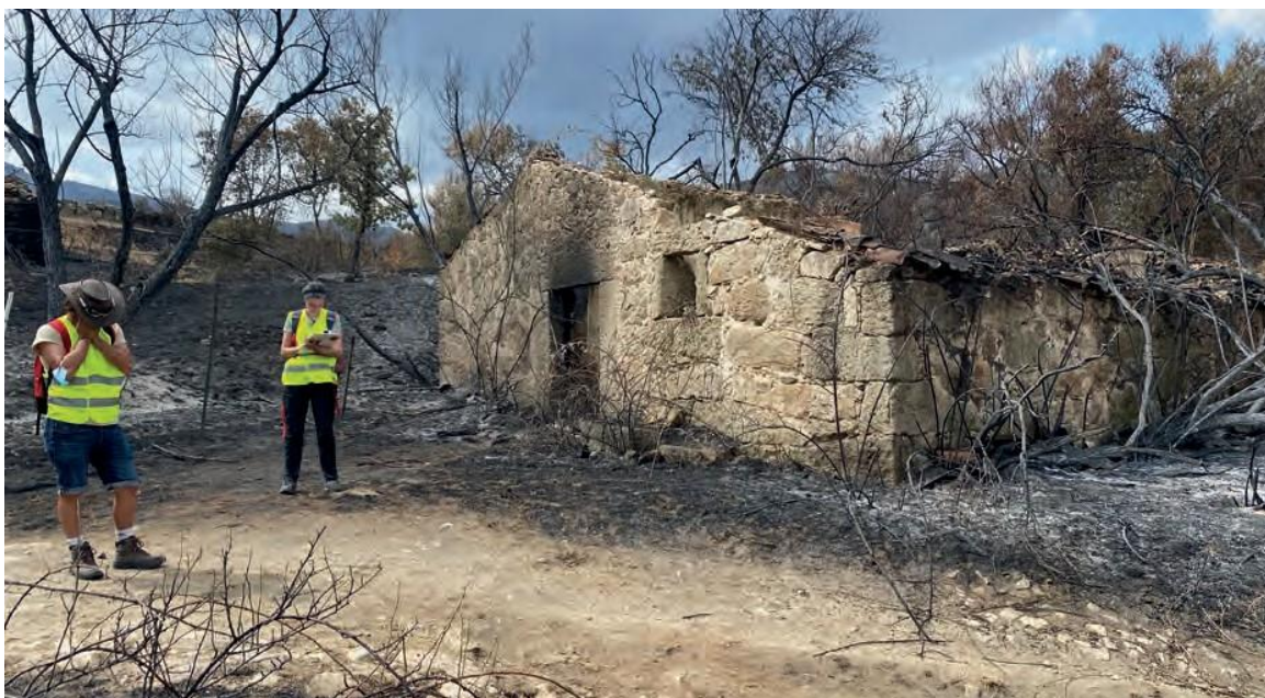
19 Évaluation des dommages causés aux sites archéologiques et à l'architecture vernaculaire après l'incendie de forêt de Navalacruz (Ávila. Espagne) en 2021
