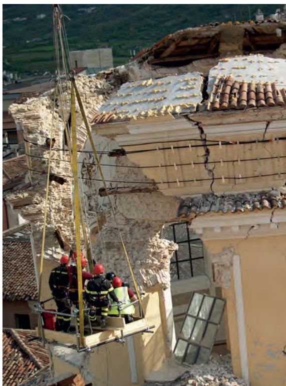
30 Des pompiers sécurisent le dôme de l'église d'Anime Sante (L'Aquila).
